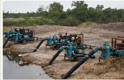
Pompa air tanah di sumber
